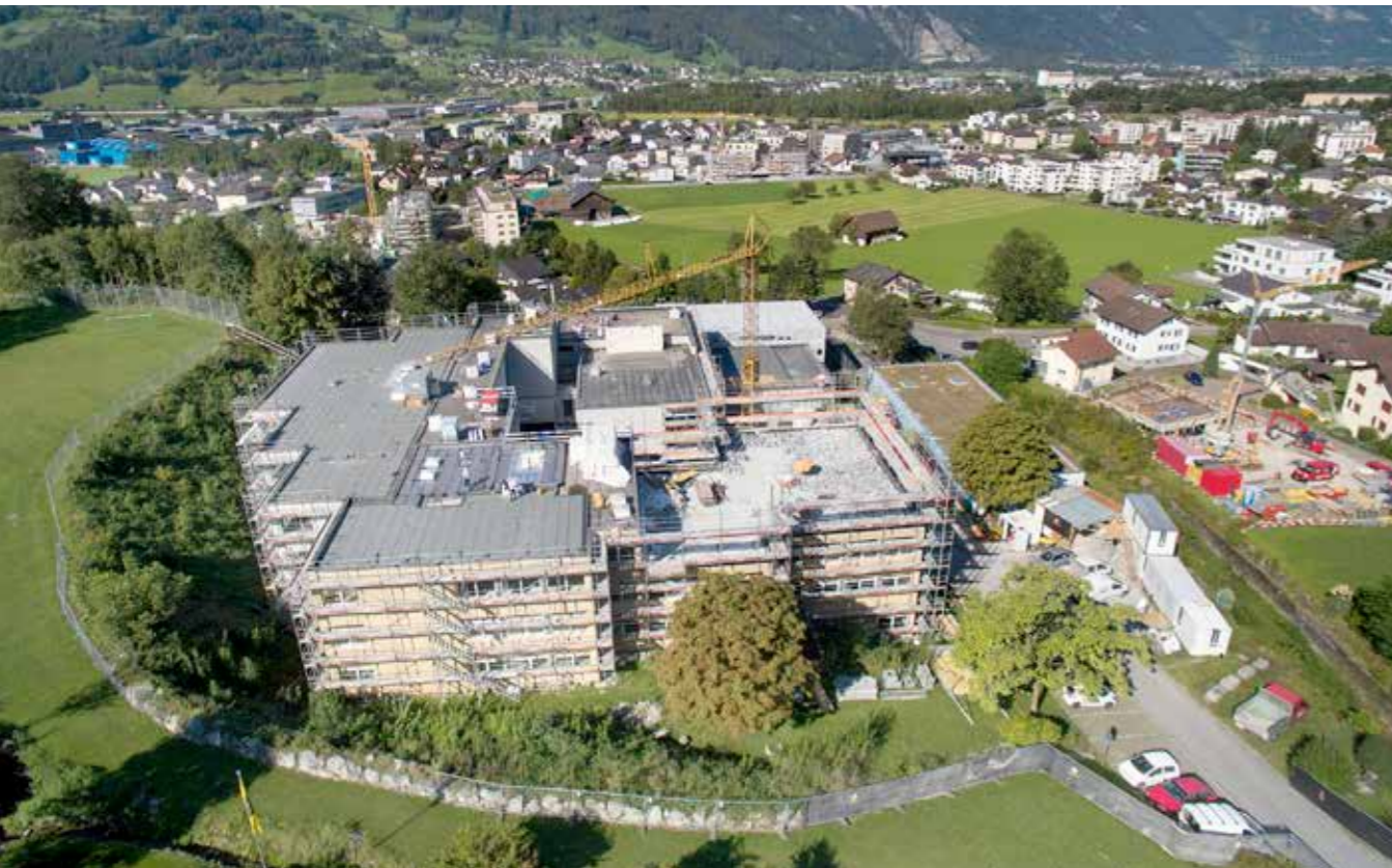
Die grösste Baustelle in Schattdorf sind zurzeit die Schulanlagen Gräwimatt. Auch wenn nächstes Jahr alles wieder nigelnagelneu ist: Die nächste Sanierung kommt bestimmt.
